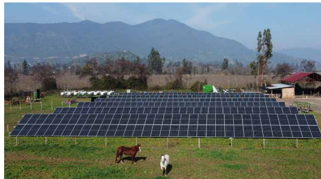
GRAMMER SOLAR | Proyecto: Pidihuinco Bajo | Ubicación: Chimbarongo, VI Región | 183,6 kWp
