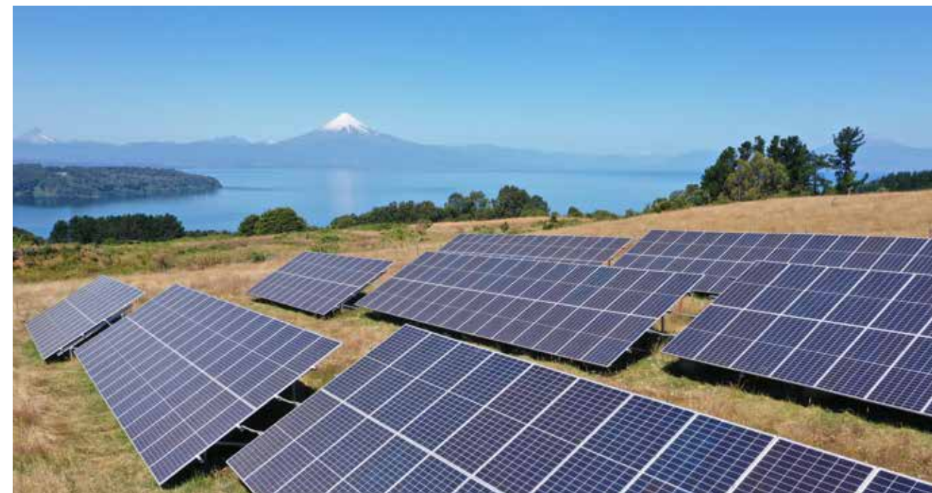
RISING SUN | Proyecto: Espantapájaros | Ubicación: Los Lagos, Puerto Octay | 77 kW
