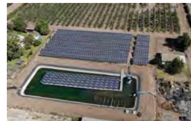
CINTAC Proyecto: Agrícola Aguas del Valle Spa, Ubicación: María Pinto, RM Potencia: San Gregorio suelo 210,6 kWp, San Lorenzo flotante 32,4 kWp.
