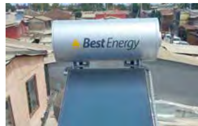
BEST ENERGY Proyecto: 350 SST en viviendas sociales. Ubicación: Santiago 2.240 MM en ahorro.
