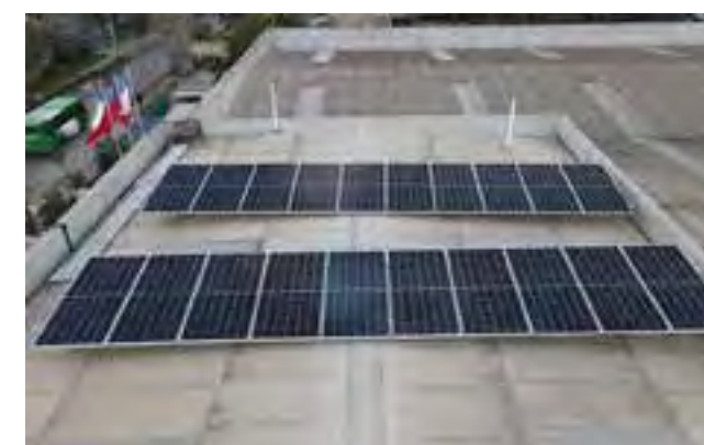
CITYSUN Proyecto: Sistema off-grid que respalda la iluminación y sistema de termos eléctricos. Potencia: 9kw en FV, 15k va de inversor más 22kwh de baterías de litio.
