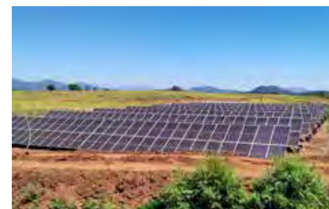
CLEANLIGHT Proyecto: Sociedad Agrícola Guerrero Potencia: 200kWp Energía generada: 70,9 kg CO2 mensuales
