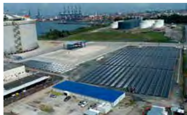
5B Ubicación: Colon, Panama Potencia: 2 MWp
